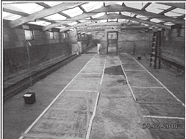
Foto 5. Opstelling pompen nr 13 en 14 en de trap/
