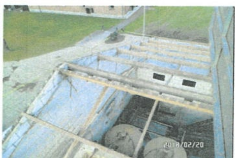
Foto 8 : nok, dakvlak, muur en kelder
