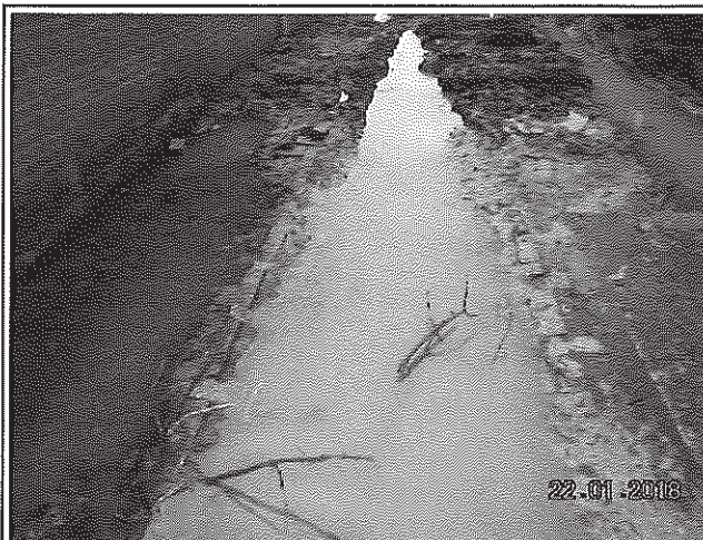
Foto 28. Maaiveld rond om opstal 4 is niet vrijgegeven omdat het niet inspecteerbaar is.
