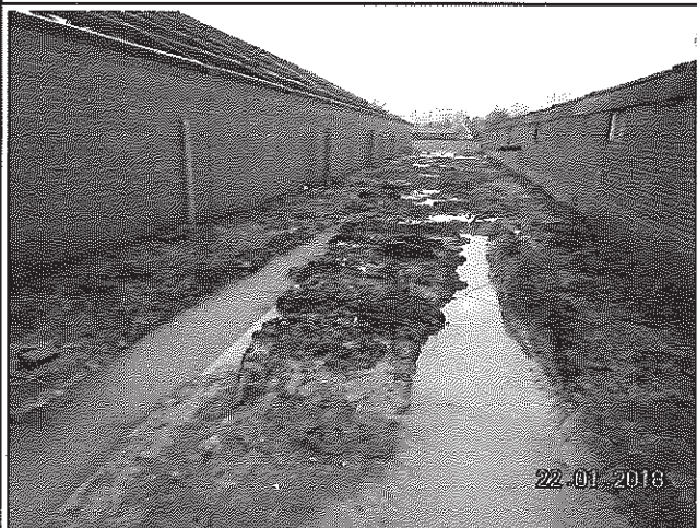
Foto 26. Maaiveld rond om opstal 4 is niet vrijgegeven omdat het niet inspecteerbaar is.
