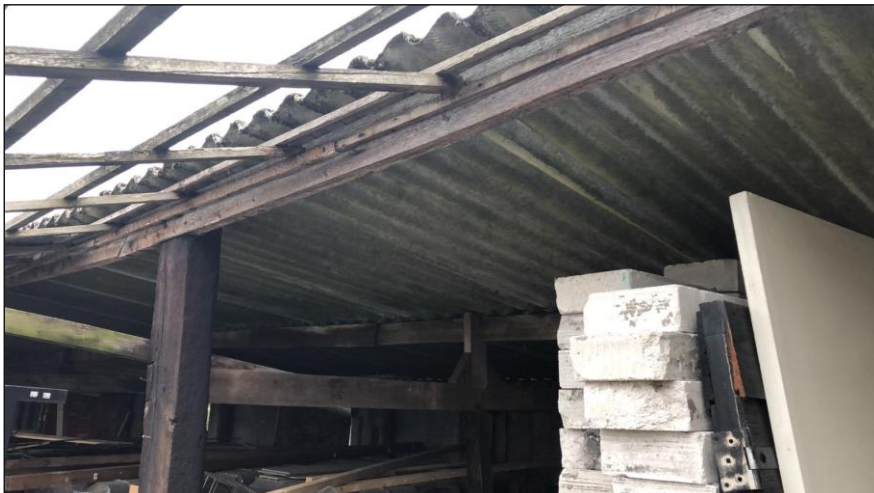
Figuur 20: Dak van het bijgebouw. Het dak is incompleet
