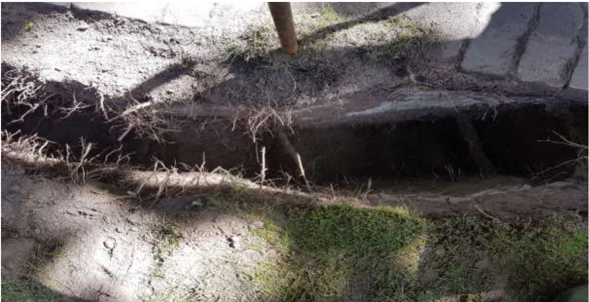
Figuur 7. Profiel proefsleuf een beide kanten onder het maaiveld gegraven breedte ruim 2 meter.
