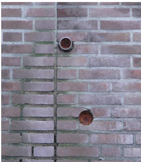
Foto 28 dicht gepurde oude leiding door- Voeren geb.40-6
