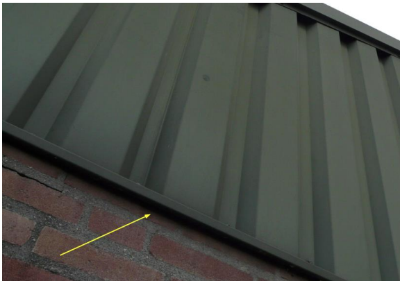
Foto 26 dichte afdichting beplating Z gevel Geb. 40-4
