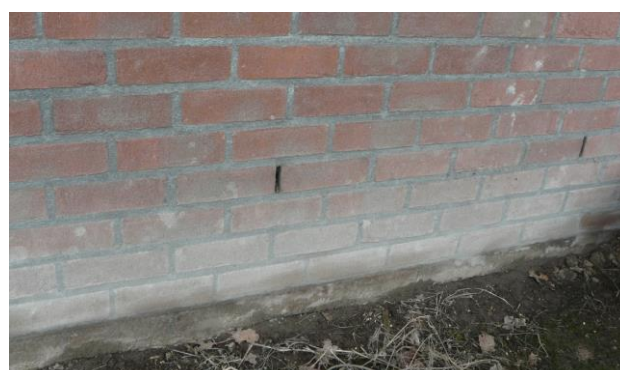
Foto 33 laag aanwezige open stootvoegen geb.30-6 Met spinrag erin
