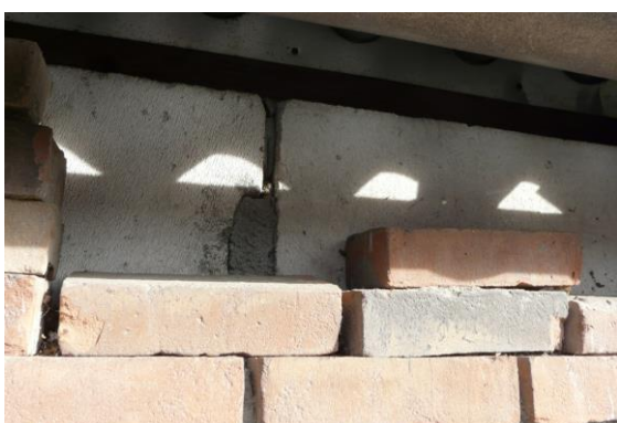
Foto 32 groter gat in zijgevel geb. 30-8 zeer Tochtig. Binnenwand strak tegen buitenwand.
