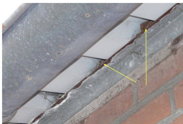
Foto 15 'golfafdichting' PUR gebouw 40-11
