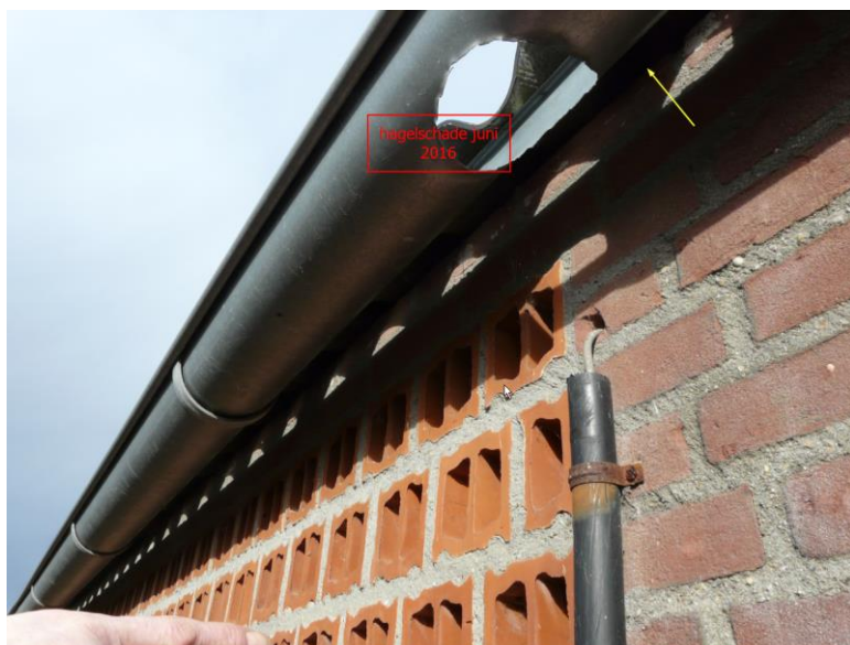
Foto 13 'golfafdichting' PUR gebouw 30-7
