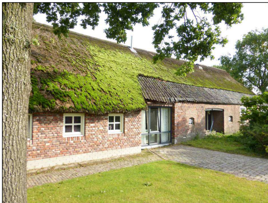
Figuur 6: Zicht op oostelijk deel woonboerderij, in de huidige situatie nog niet ingericht ten behoeve van bewoning.
