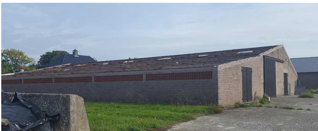
Figuur 28: Beeld van de stallen waarvan de daken door de hagelstorm van 23 juni 2016 verwijderd zijn
