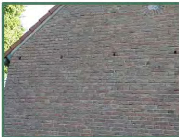
Open stootvoegen in de zuidelijke wand
