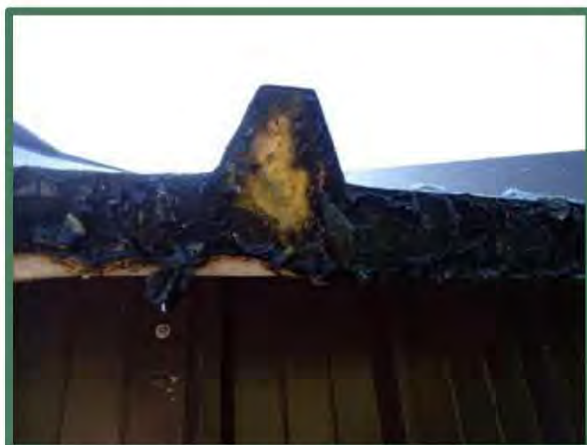
Gebrek aan ruimte tussen de sandwichpanelen
