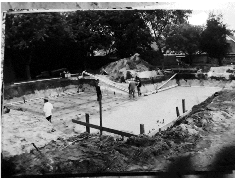
Op de foto is te zien dat eerder al buiten de keldermuren om nog eens 2 meter is uitgegraven. Dit geldt ook voor appartementencomplex hoek Postelstraat/Melchertstraat
