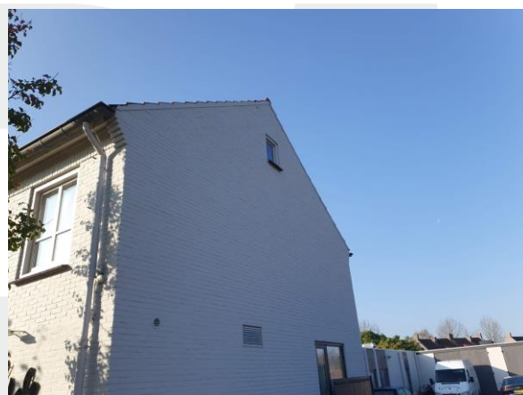
Zijgevels woning; geen stootvoegen en/of kieren in de strak afgewerkte gevels. De gevelpannen van de woning en het horecapand zijn strak afgesmeerd met cement
